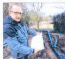
Rohrputzmeister Frank Zuhl schaut auf dem Plan nach, ob alle Leitungen richtig liegen.
